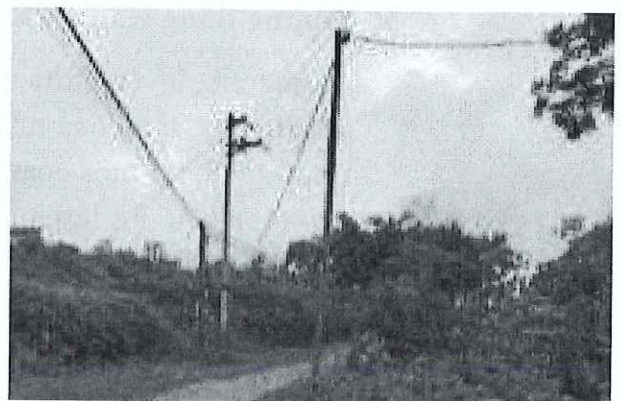
Đường điện trung và hạ thế dọc tuyến
