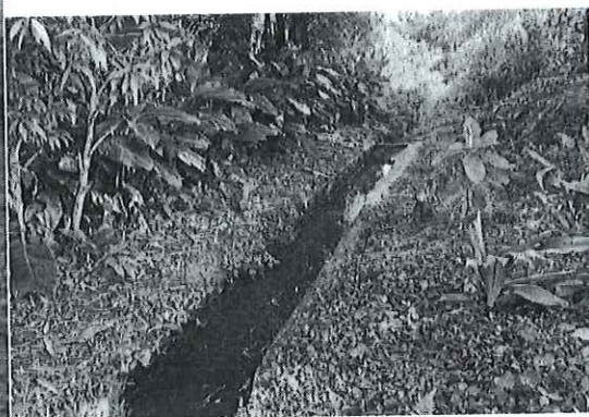
Hiện trạng kênh bị bong tróc, nứt vỡ
