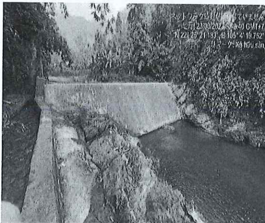
Hiện trạng đập đầu tuyến kênh
